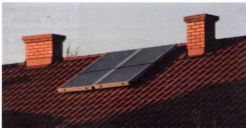
Rys. 4.2. Umieszczone na dachu kolektory słoneczne, wykorzystywane do ogrzewania wody w budynku
