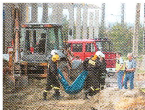
Rys. 2.2. Wypadki w budownictwie – podczas budowy zginęło dwóch robotników przysypanych ziemią
