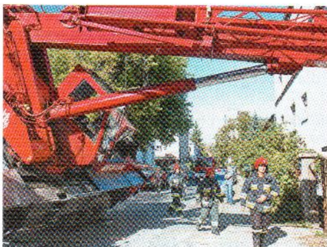
Rys. 2.1. Wypadki w budownictwie – śmiertelny wypadek podczas budowy spowodował dźwig przenoszący materiały, jedna osoba została ranna
